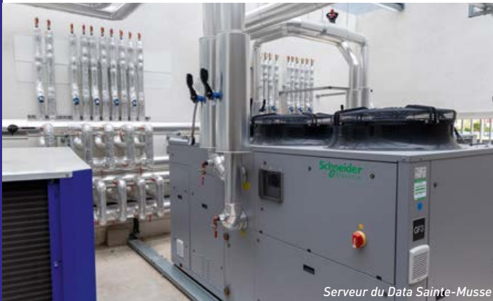
Serveur du Data Sainte-Musse
